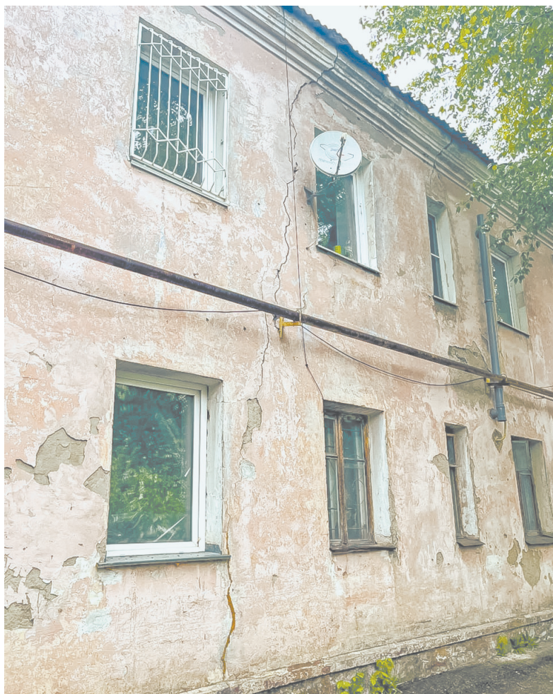
Сайдинг, которым обшивают старые дома, может скрывать вот такие опасные трещины.
